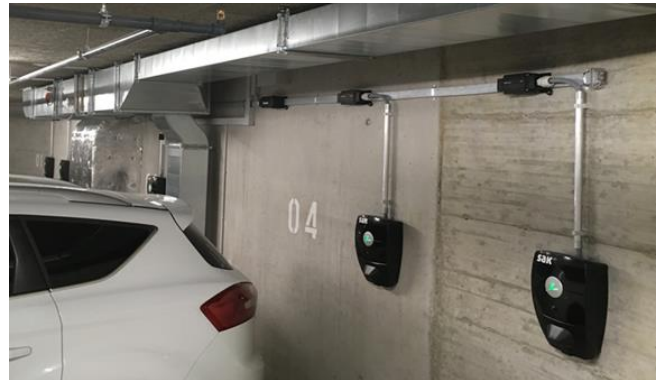
Installierte SAK E-Ladelösung mit «ZapCharger Pro» (Bild: SAK).
