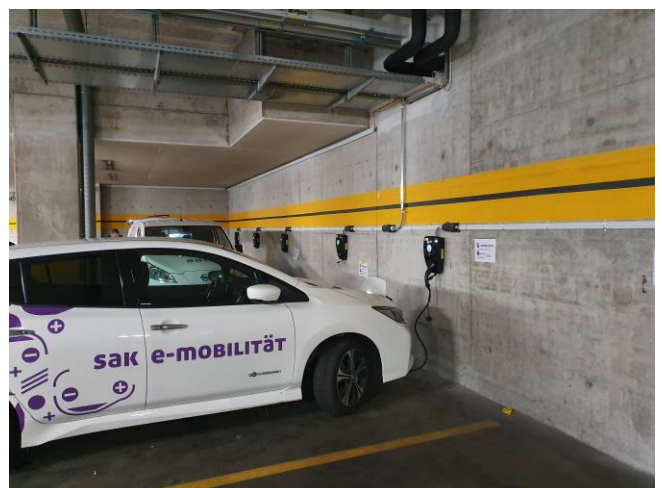
ZAP Charger-Stationen im PSP Swiss Property-Geschäftshaus an der Förrlibuckstrasse 60/62 in Zürich (Foto:SAK).
