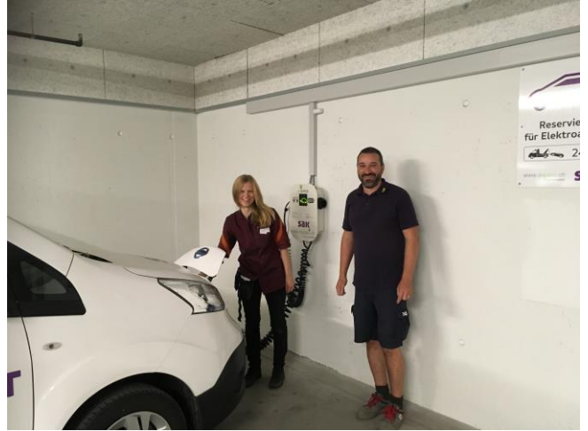
Freuen sich über die neu installierte Ladestation: Janine Meier, Stv. Filialeiterin Migros-Supermarkt Symondpark Davos und Andreas Aebli, Servicemonteure SAK.
