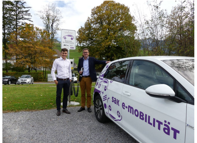
Freuen sich über die neu installierten Ladestationen: Christian Lienhard, Gastgeber des Hof Weissbad (rechts), und Jan Müller, Projektleiter Elektroinstallation der SAK.
