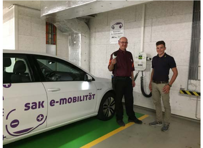
Freuen sich über die neu installierte Ladestation: Stephan Furrer, Filialleiter Migros Münchwilen (links) und Jan Müller, Projektleiter Elektroinstallationen SAK.
