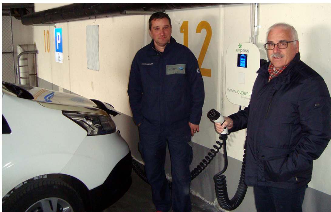
Amdens Gemeindepräsident Markus Vogt (rechts im Bild) und Andreas Aebli, SAK Servicemonteur nehmen die neu installierte Ladestation im Parkhaus Ruestel in Betrieb.
